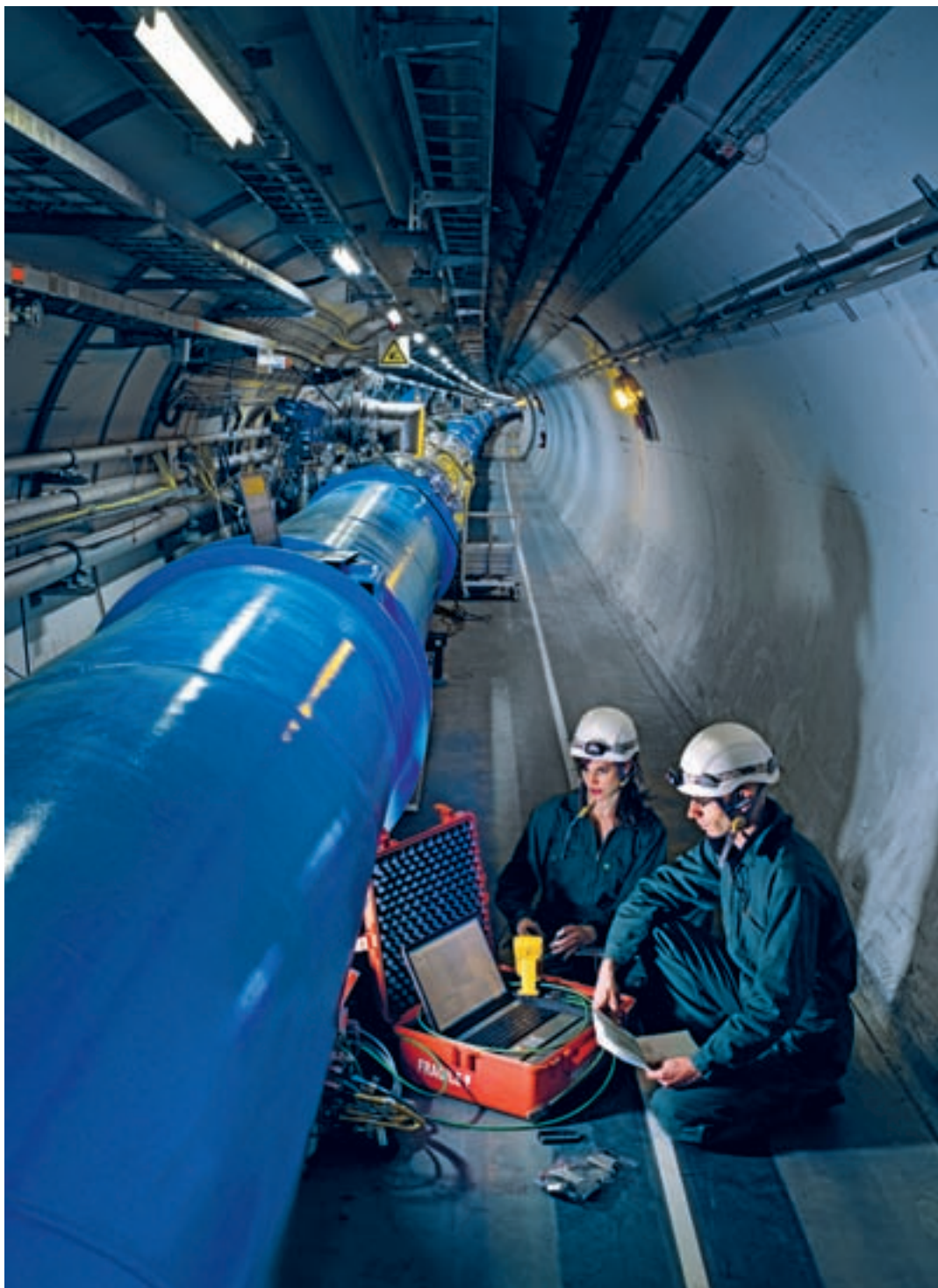
Ingenieure prüfen die Elektronik eines LHC-Dipolmagneten.
